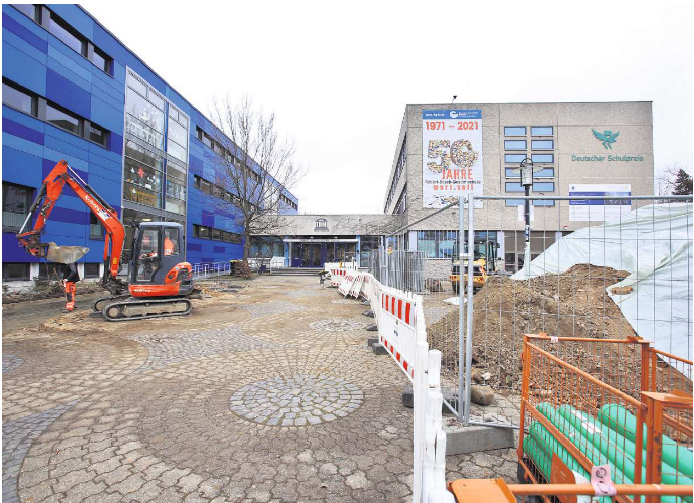
Die RBG ist in den nächsten Jahren eine Dauer-Baustelle, derzeit lässt die Stadt eine Radstellablage errichten – doch das ist nur der Auftakt. FOTO: JULIA MORAS
