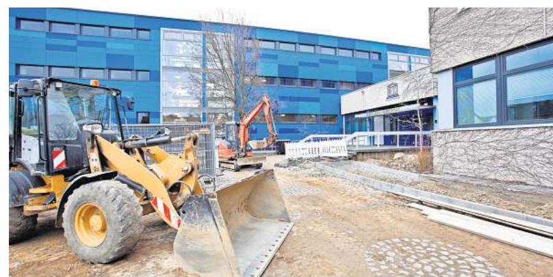
Am Haupteingang haben die Arbeiten bereits begonnen. Hier entsteht eine neue Abstellanlage für Fahrräder. FOTOS: JULIA MORAS
