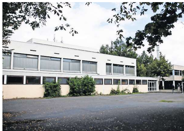
In der Sporthalle der Robert-Bosch-Gesamtschule machen unter anderem das Dach und die Gebäudehülle Probleme.
